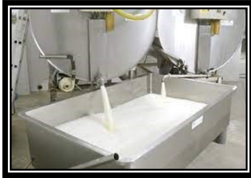
Imagen 3.67 Sistema de almacenamiento y enfriamiento de leche.
